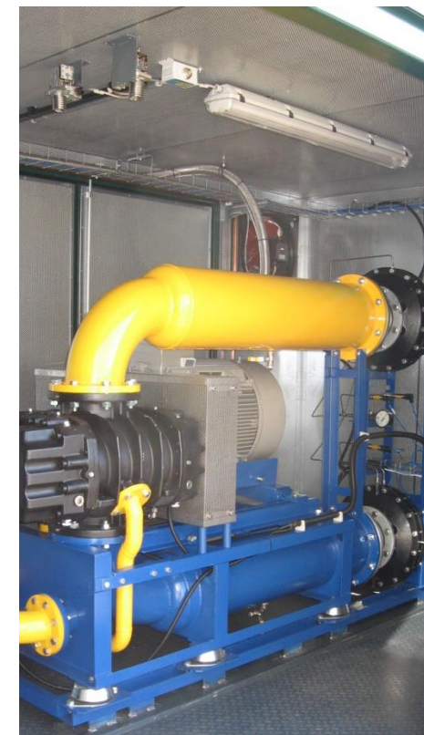
Unidades de sopladores de gas – vacío con pre- enfriamiento con intercambiador de calor
