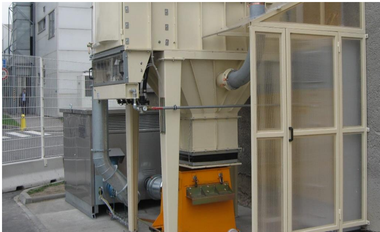
Unidades de sopladores de vacío -Filtración
